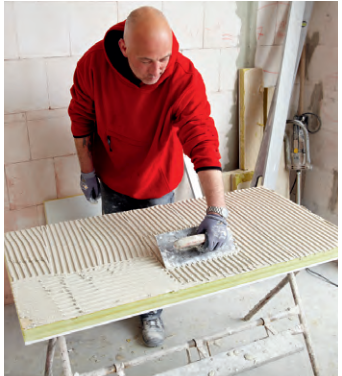
Zur energetischen Ertüchtigung der Fassade fiel die Wahl auf leistungsstarke Innendämmsysteme wie die „Aerorock® ID“ von Rockwool. Vollflächig verklebt ...
